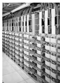
Стойка сверхвысокой плотности SHD. Вид сзади
