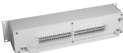
Панель 32 цепи (вид сзади)
